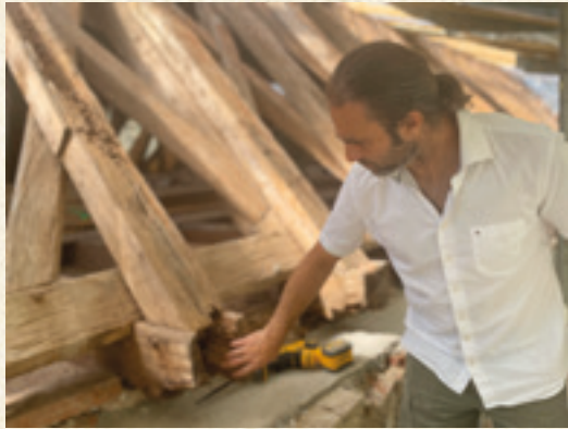
Beim Dachstuhl fehlt der äußere Querbalken, auf dem die Sparren aufliegen.
