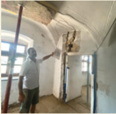
Als noch der Putz drauf war, verdeckte nur ein kleiner Riss die schadhafte Mauer
